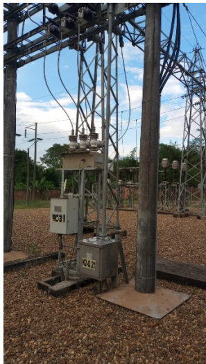
Ilustración 2. Reconector de reemplazo Doghouse Nivel de tensión 2 (TP2)
