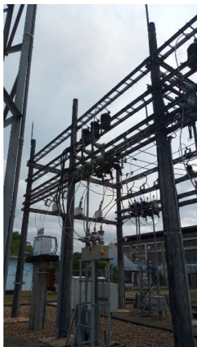
Ilustración 6. CT's N2 – Asociados al módulo de barraje del transformador T01
