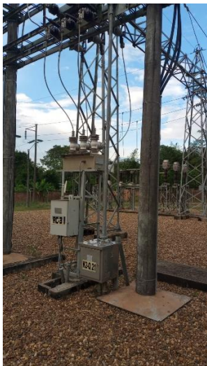
Ilustración 9. Reconector de reemplazo Dog house Nivel de tensión 2 (TP2)
