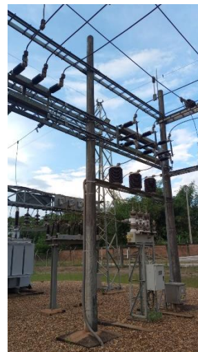
Ilustración 7. CT's N3 – Asociados al módulo de barraje del transformador T02
