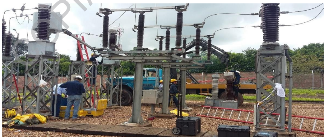
Imagen Instalación de Pts. tipo capacitivo
